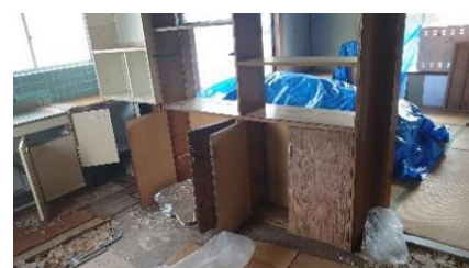
Nさんの自宅。天井が抜け、泥が床に散乱している。
