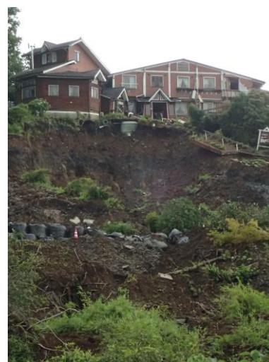
南阿蘇にある土砂崩れにあったペンション
