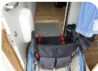
車いすが入らない仮設住宅の玄関
